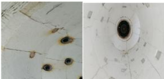
Gambar 2. Keretakan pada castable refractory
