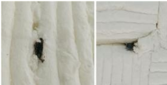
Gambar 1. Kerusakan pada ceramic wool
