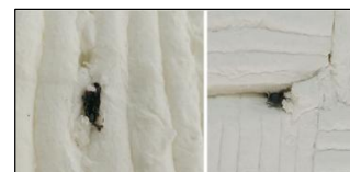
Gambar 2. Kerusakan pada Ceramic Wool
