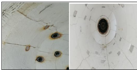
Gambar 3. Keretakan pada Castable Refractory
