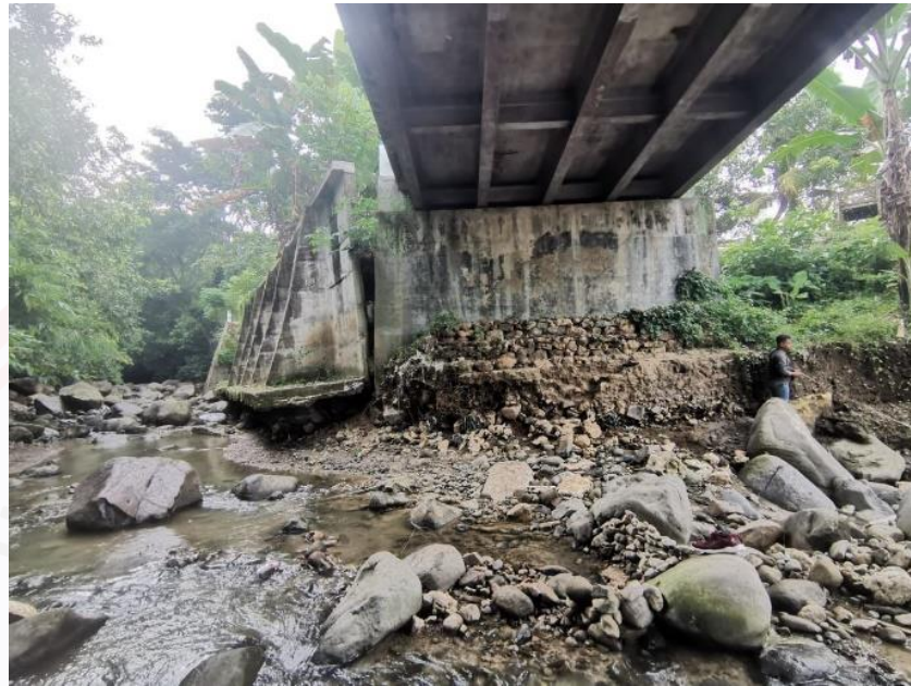
Gambar 1.2 : Kerusakan Pada Jembatan Sumber : Dokumentasi Penulis.
