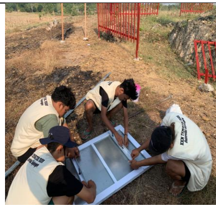
Gambar 4. Pemasangan Perlengkapan Papan Narasi
