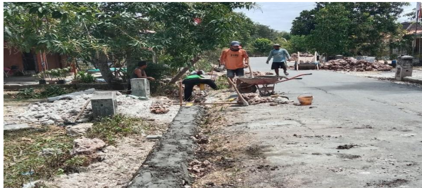
Gambar 5. 1 Pekerja Yang Belum Menggunakan APD
