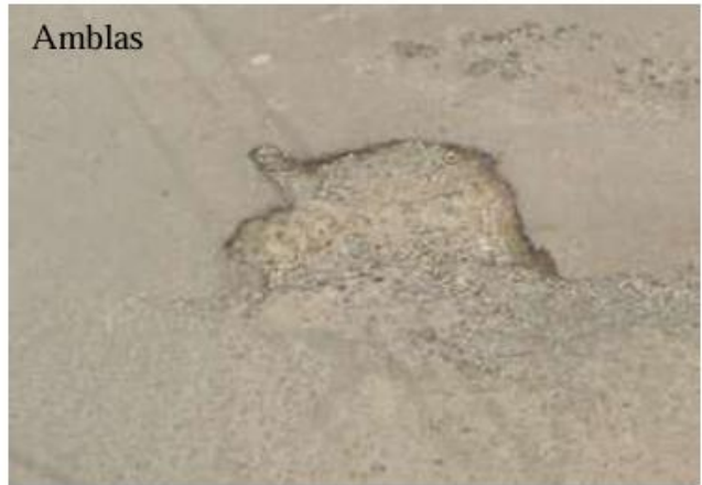
Gambar 4.7 Gambar Kerusakan Perkerasan Jalan Seksi 3
