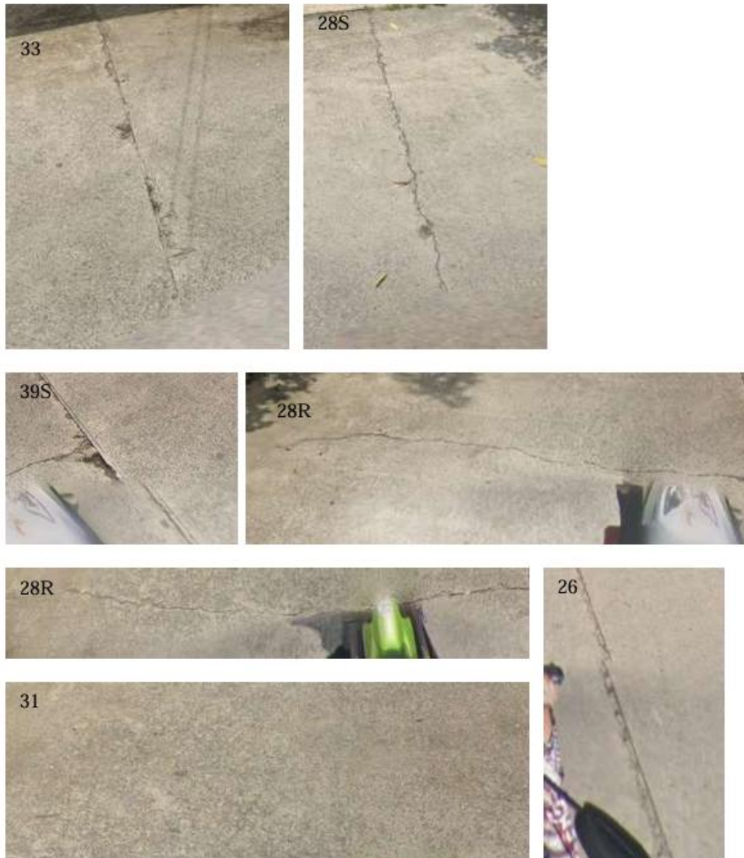
Gambar 5.13 Gambar Kerusakan Perkerasan Jalan Seksi 6
