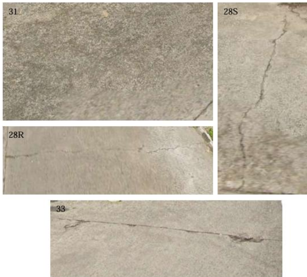
Gambar 5.11 Gambar Kerusakan Perkerasan Jalan Seksi 5
