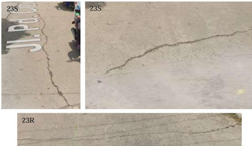
Gambar 4.8 Plot Kerusakan Perkerasan Jalan Seksi 4
