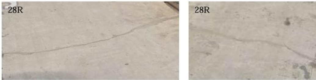
Gambar 5.5 Gambar Kerusakan Perkerasan Jalan Seksi 2
