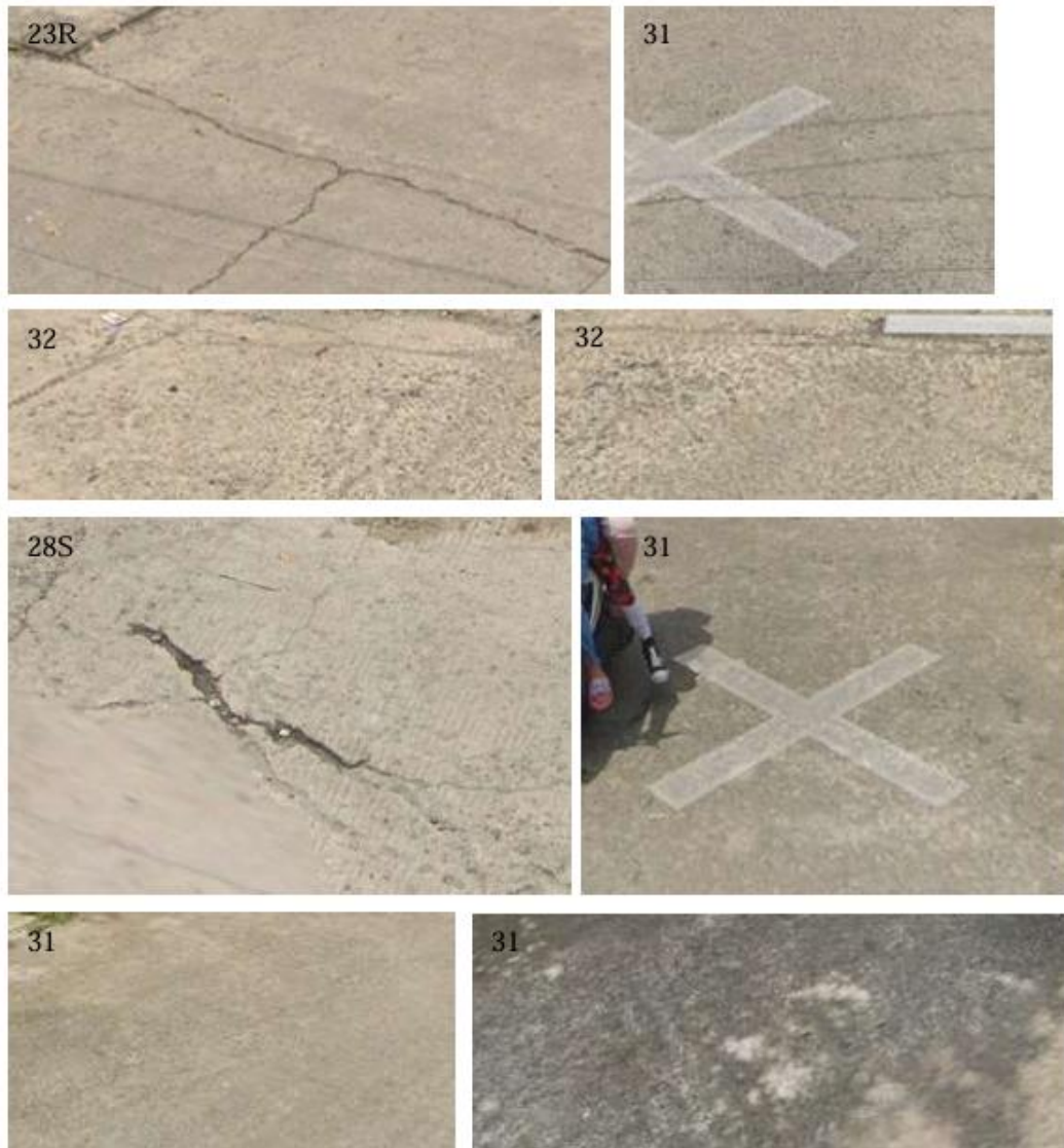
Gambar 5.9 Gambar Kerusakan Perkerasan Jalan Seksi 4
