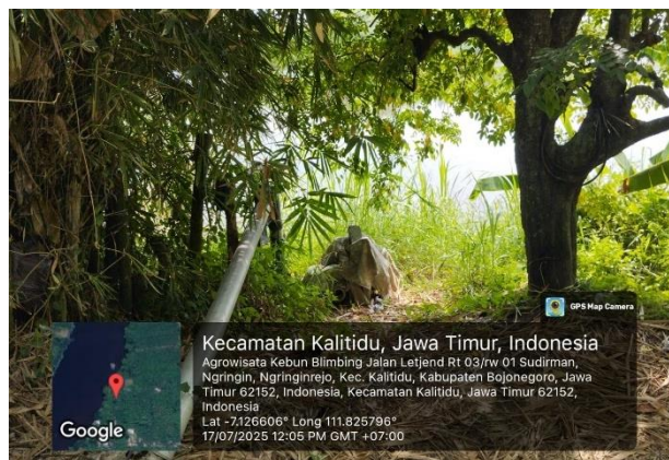
Gambar 3. 35 Survei Lokasi Pompa di Biosite Kebun Belimbing Desa Ngringinrejo
